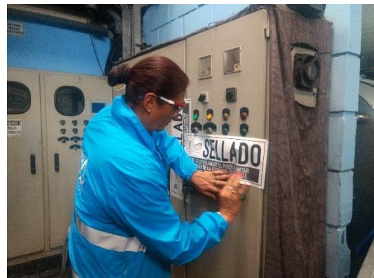
FOTOGRAFÍA 4. IMPOSICIÓN DE MEDIDA PREVENTIVA EN FLAGRANCIA SOBRE EL TABLERO DE CONTROL
