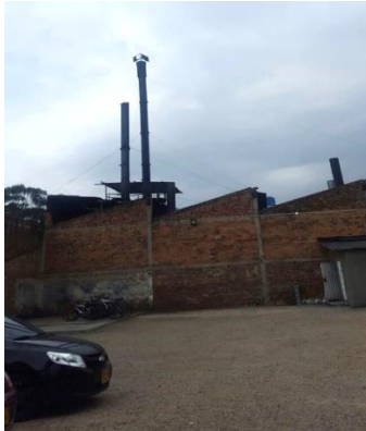
FOTOGRAFÍA 4. DUCTOS DE DESCARGA
